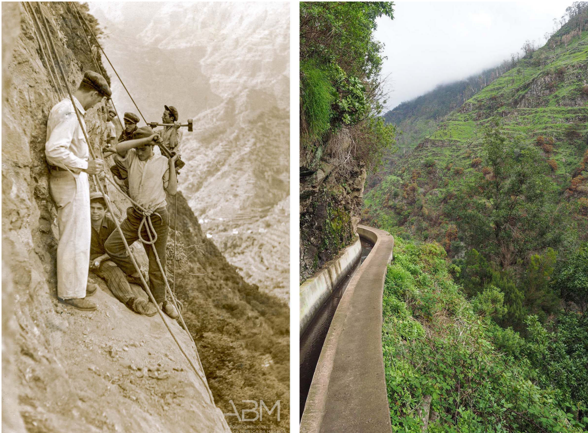
Figura n.º 5 – Construção da Levada do Norte – o Engenheiro e os Operários (à esquerda); Vista Atual da Levada (à direita)
